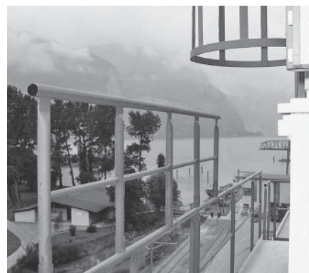
Bild 8: Leitereinstieg auf hoch gelegenen Laufsteg. Das erhöhte Geländer dient als zusätzliche Absturzsicherung.
